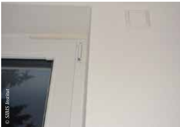
Fensterkontakte zur Einbruchssicherung und Anzeige, ob Fenster noch geöffnet (wird beim Verlassen der Wohnung angezeigt)
