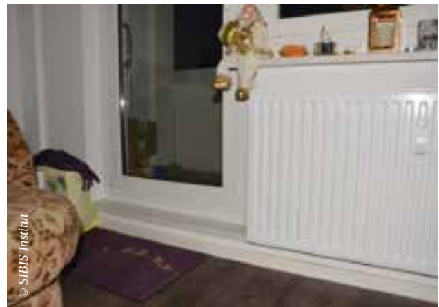
Hohe Schwelle am Balkonaustritt
